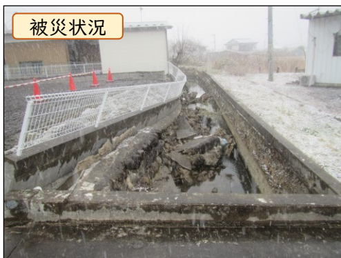
石積コンクリート破損
