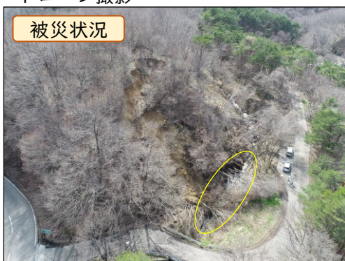
山林の倒木及び法面崩落
